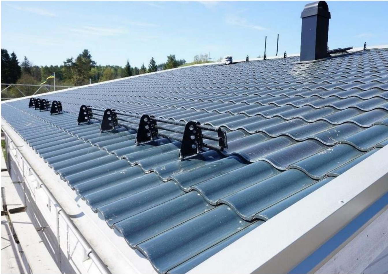
Instalacja wykonana w Szwecji (źródło - Hanergy).
