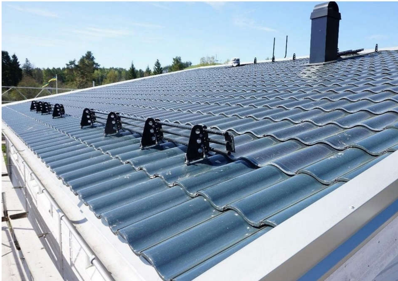
Instalacja wykonana w Szwecji (źródło - Hanergy).
