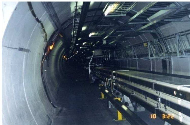
Rys.1.2.7 LEP akcelerator w tunelu.
